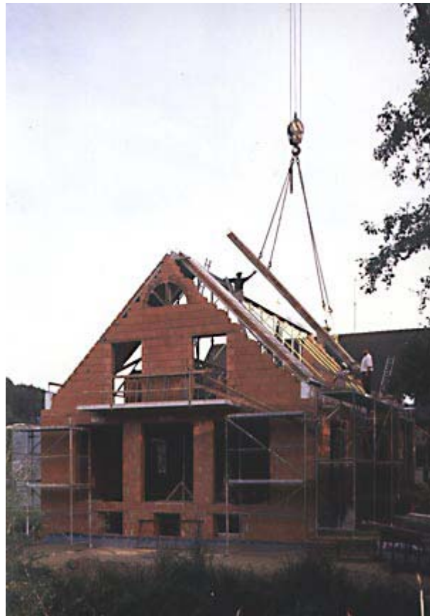
Nach dem Versetzen des Hilfsmontageträgers am First können die Massivdachelemente als sog. Sparrenbauweise zügig montiert werden.
